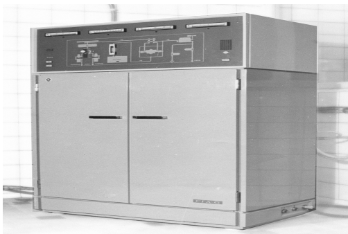
Фото 3. Центральный пост СГД-6
